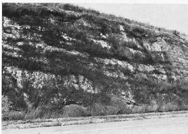
Abb. 5 Begrünter Nagelflugheinschnitt. Weil auf solcher Unterlage keine geschlossene Grasnarbe erzielt werden kann, hätte der Einschnitt stärker abgeflacht werden müssen, damit der im Frühjahr herausbröckelnde nicht den Verkehr gefährdet.
