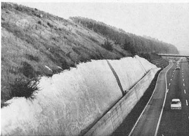
Abb. 6: Ein zugleich gutes und schlechtes Beispiel einer Mergel-Böschung (Molasse). Oben 2:3-Böschung mit unterhaltsarmer Begrünung und natürlich aufwachsendem Gebüsch im vierten Jahr nach der Aussaat. Unten die zu kleine Stützmauer. In der Mitte die Steilpartie, welche sich nicht begrünen ließ und nachträglich gunitiert werden mußte. Für die Wahl von Begrünungsart, Stützmauern usw. ist vor allem das mutmaßliche Verhalten der dem Wetter ausgesetzten Molasse-Oberfläche ausschlaggebend. Mit Begrünung und Beton ist eine geschlossene Verkleidung anzustreben.
